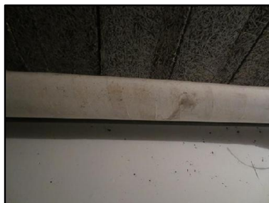
Photo N° 651 ECH-N°3 CALORIFUGEAGE --LOCAL POUBELLE 1 Conduits de fluide Laine minérale + enveloppe plâtrée
